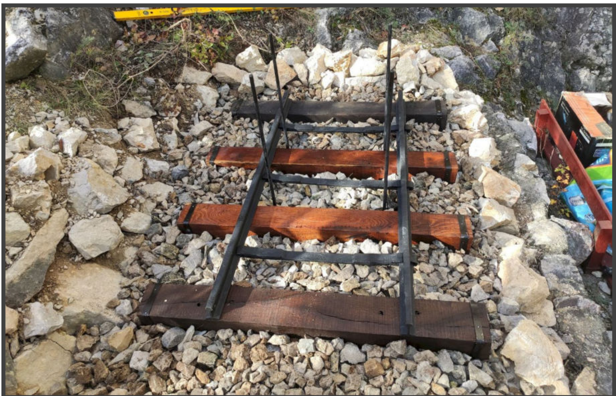
Nyomtávtartó rudak felhelyezése és a nyomtáv beállítása. Ezt követően a talpfák közeit teljesen feltöltöttük zúzottkővel.
